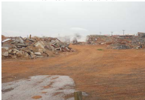
Imagem 3: Materiais após a umidificação destes. Usina de Reciclagem de Entulhos em Hortolândia.
