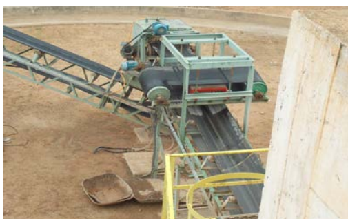
Imagem 6: Esteira Magnética. Usina de Reciclagem de Entulhos em Hortolândia.
